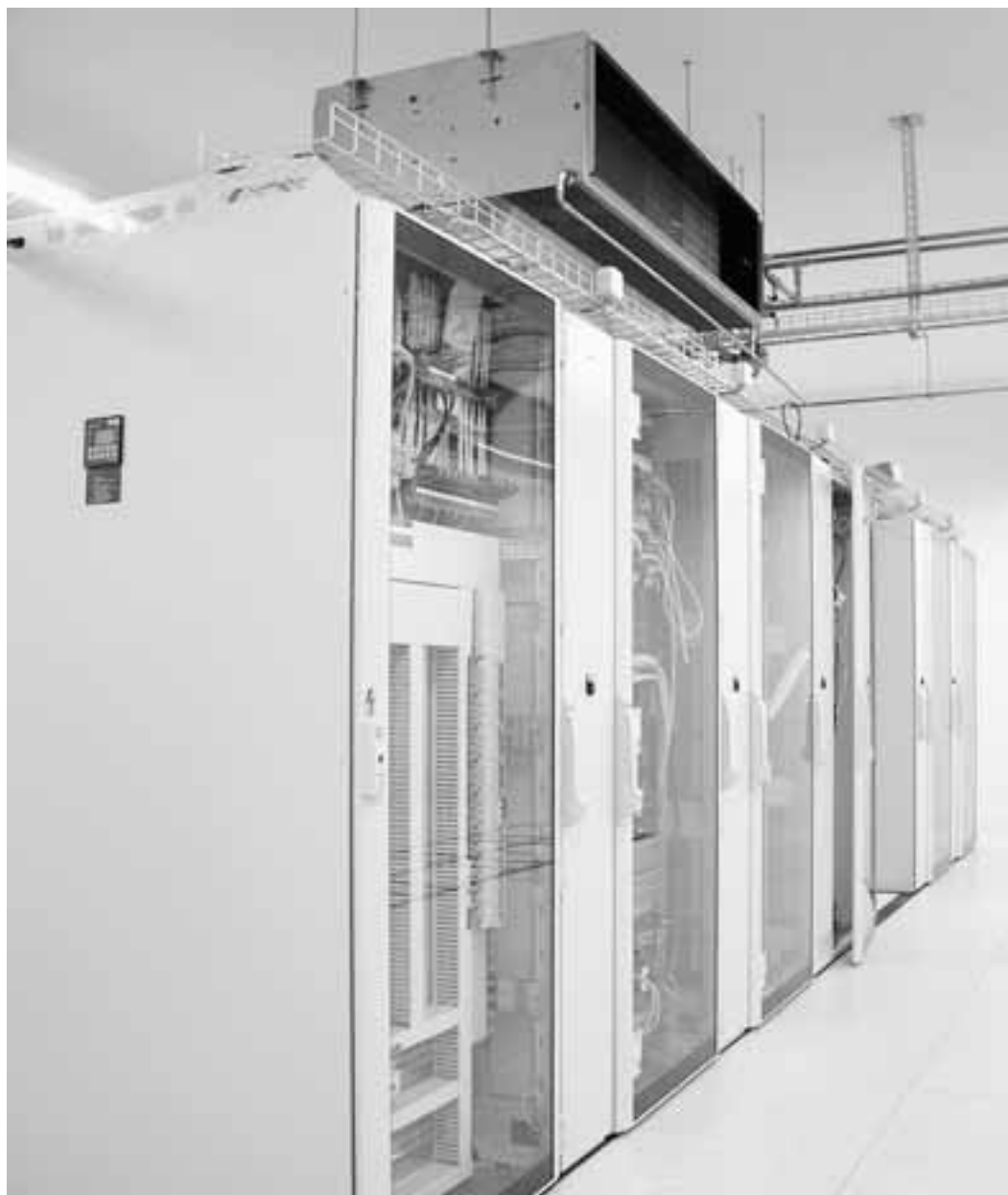
« Tresor » Rechenzentrum: Die Server der Talus Informatik AG in Wiler bei Seedorf umgibt seit Kurzem ein aufwändiges Sicherheitssystem, auch die «in4U» investierte Millionen in die Sicherheit. Bild: zvg
